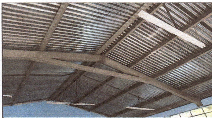
Foto 3: mantenimiento de la estructura del techo es muy importante ya empenzo a oxidarse algunas partes.
