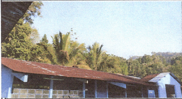
Foto 1: Sustitucion del entechado a laminas troqueladas calibre 26 estan muy oxidadas, algunas partes le entra agua.
